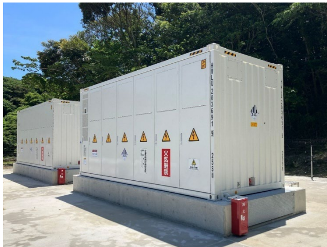
いちご御宿岩和田ECO蓄電所
